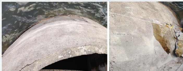
Epaufures et décollement du béton de la voute
