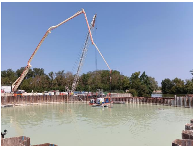
Coulage du béton immergé, préalablement à la réalisation du radier de la station principale
