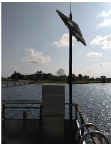
Installation d'une station de mesure de hauteur du bassin sud (Marne) autonome en énergie (panneau solaire)
