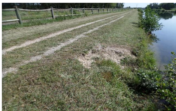
Effondrement de la berge du canal de restitution Seine
