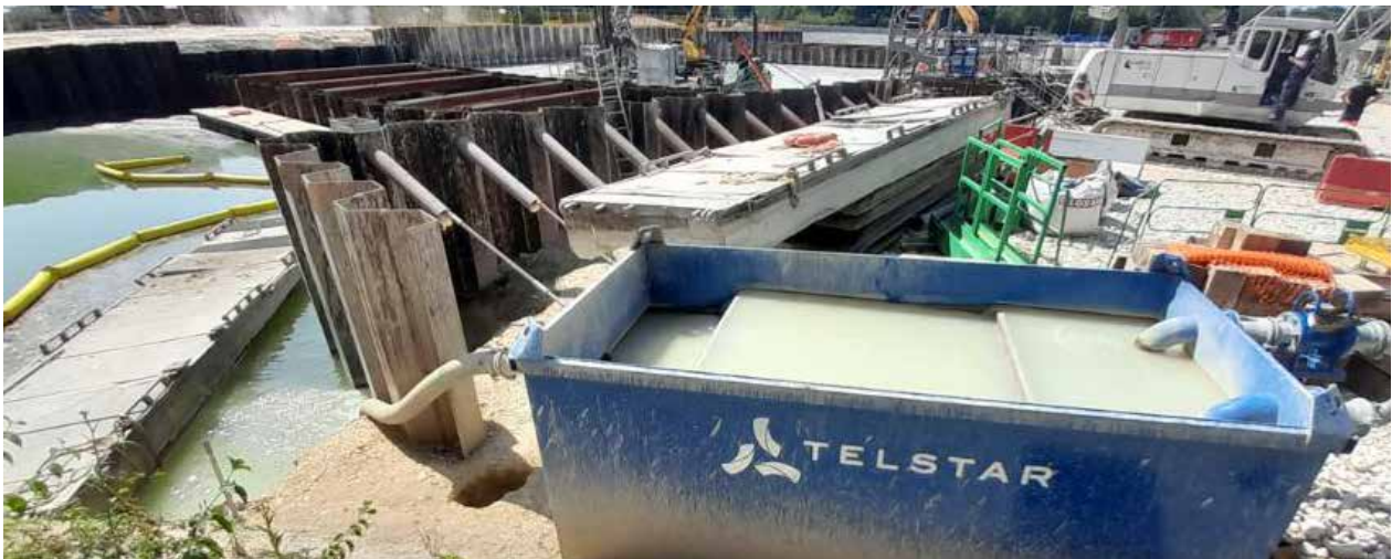
Station de pompage : rejet des eaux pompées après passage par le bac de décantation - 2023
