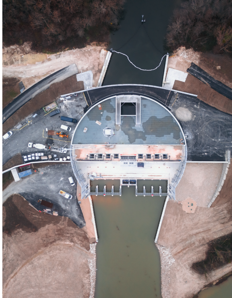
► Vue de la station de pompage principale
